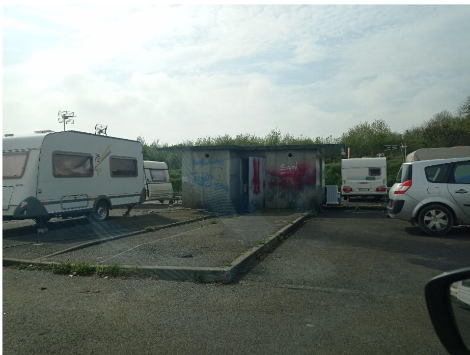
Aire de Guingamp : photo d'un bloc sanitaire défectueux
